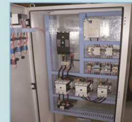
Control Cabinet 控制柜内部
